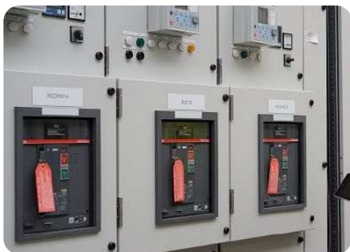
Mantenimiento de Subestaciones
