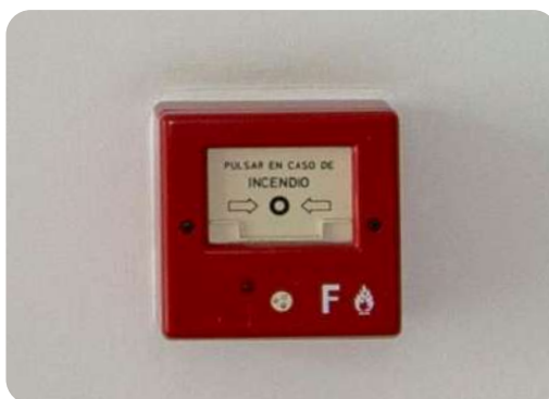
Sistema de Alarma Contra Incendios
