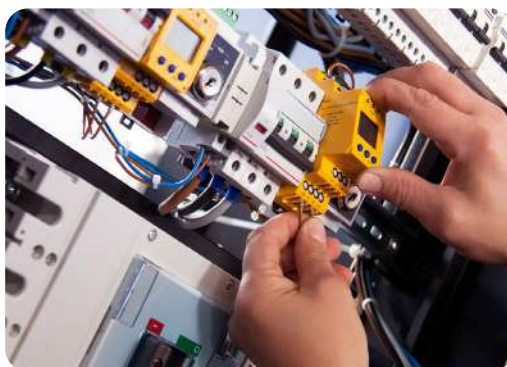
Instalaciones de Baja Tensión
