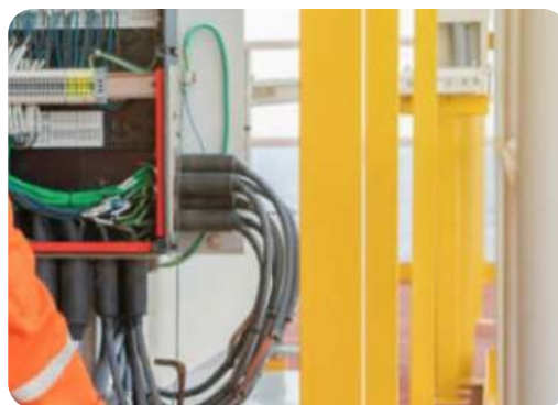
Mantenimiento de Estación, MT y BT
